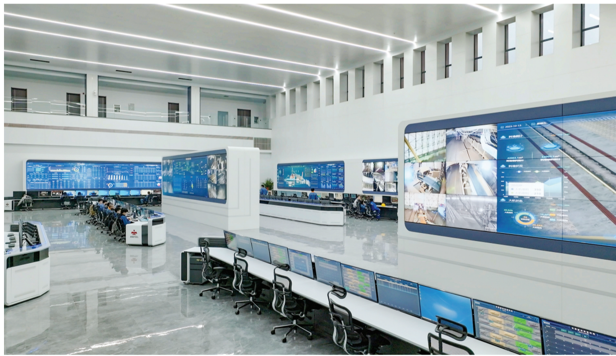
本钢板材铁前集控中心集控大厅。
